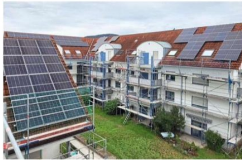
Das Mehrgenerationenhaus in der Gaggenauer Victoriastraße erhielt eine Photovoltaikanlage. Insgesamt installierte die BG im Jahr 2023 stolze 150 Kilowatt-Peak. Foto: BG Familienheim
